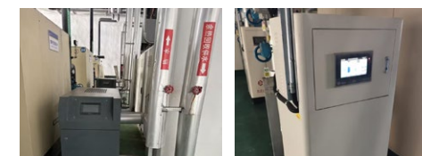
盐城立铠空压机余热回收
