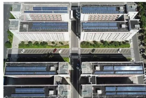
生活区光伏项目
