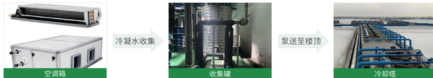
义安立讯开展空调冷凝水回收
